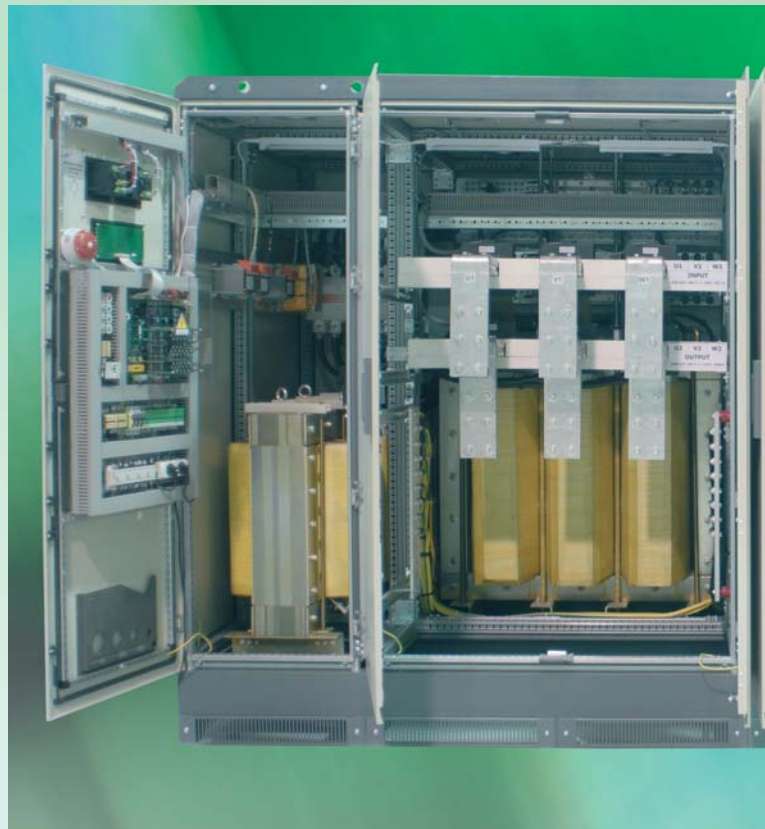
Stabilizzatore di potenza da 3150kVA: sulla sinistra il trasformatore booster e su
